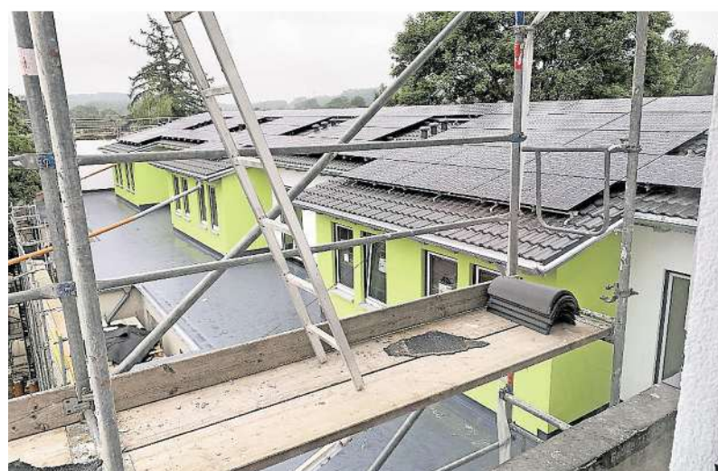
Ein weiterer Aspekt, der das Boardinghaus-Projekt „Villa Marbaise“ prägt: Photovoltaik auf den Dachflächen.
